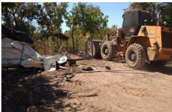
Figura 4: Destruição de uma residência por tratores na operação de reintegração de posse ilegal ocorrida contra a Comunidade Bom Acerto, Balsas/MA, em 11 de agosto de 2020
