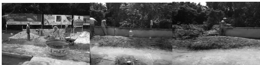
Figuras 03, 04 e 05: Pedreiros e ajudantes avançam na construção da Mureta. Fotos: José Roberto Jesus da Silva Cravo, abril 2020.
