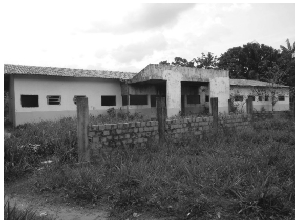
Figura 01: Construção abandonada de Posto de Saúde em Cardoso, Baião. Foto: Thamirys di Paula Cassiano de Matos, 25 de outubro de 2019).
