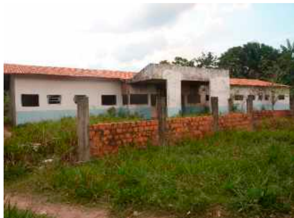
Figura 01: Construção abandonada de Posto de Saúde em Cardoso, Baião. Foto: Thamirys di Paula Cassiano de Matos, 25 de outubro de 2019).
