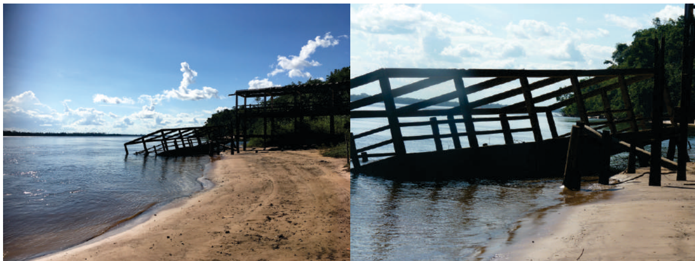
Ruínas do trapiche construído que desabou e não foi utilizado pelos pescadores de Calados.
