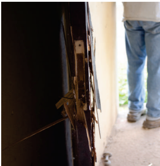
Porta de Eliane arrombada após o rompimento. Fonte: Acervo GESTA, 2017.
