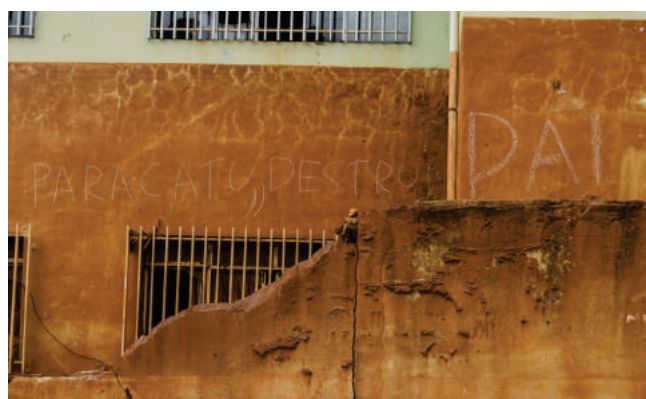
Mensagem 'Paracatu, destruída' na parede da escola. Fonte: Acervo GESTA, 2017.
