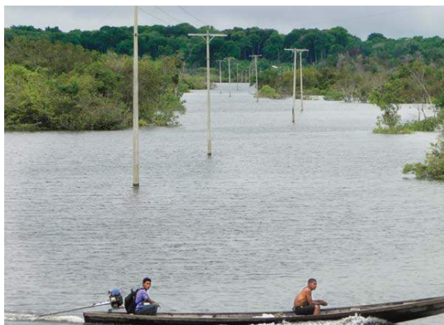
Linhão onde ocorreu a derrubada de castanhais
